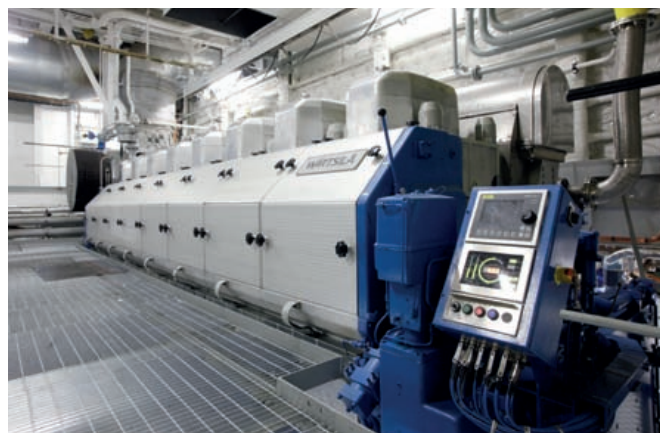
Blick in den Maschinenraum der „Viking Grace“, die von vier Wärtsilä 46 DF-Motoren angetrieben wird
